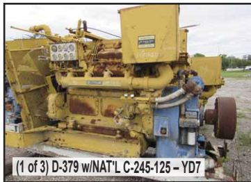
200KW Generator p/b A-C 25000 - YD7
